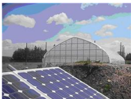
太陽光パネル設備
